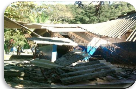
Escuela San Antonio, dañada por depresión tropical
